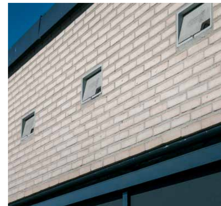
Prosjektet har murt inn fuglekasser i fasaden for å tilrettelegge for tårnseiler.
