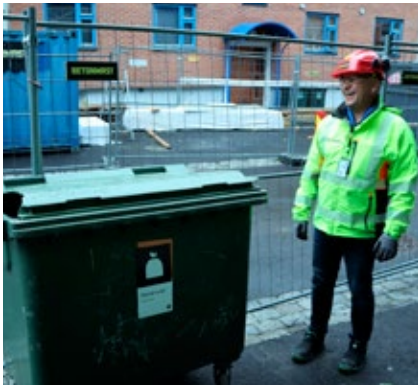
▲ Til restavfall har prosjektet i Fjæregata 1 kun en beholder på 600 liter.
